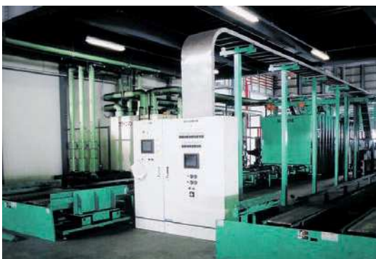
しゅうしゅつかじょう よれいしせつ 集出荷場にある予冷施設
